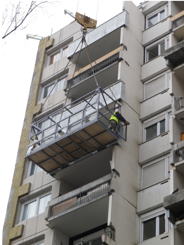
Figure 40 : Remplacement des garde corps en cours sur les balcons du 50 Arlequin. Photographie Maïlys Toussaint, 28 janvier 2016.
