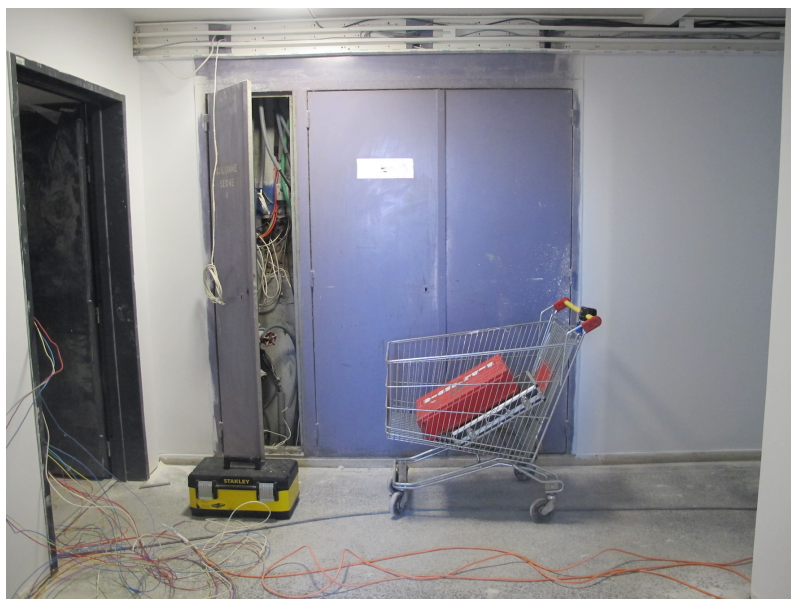
Figure 45 : Un caddie utilisé par les ouvriers pour transporter leurs outils dans un appartement en travaux au 50 Arlequin. Photographie Maïlys Toussaint, 7 novembre 2016.
