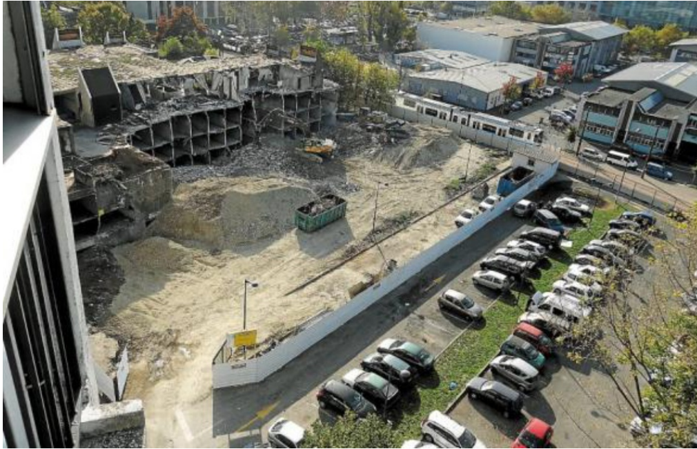
Figure 20 : Démolition du parking n°5 au pied du 40 Arlequin. Source : Manuel Pavard, « L'Arlequin entame une mue profonde », 20 minutes, publié le 24 octobre 2012. [En ligne] https://www.20minutes.fr/grenoble/1028688-20121024-arlequin-entame-mue-profonde
