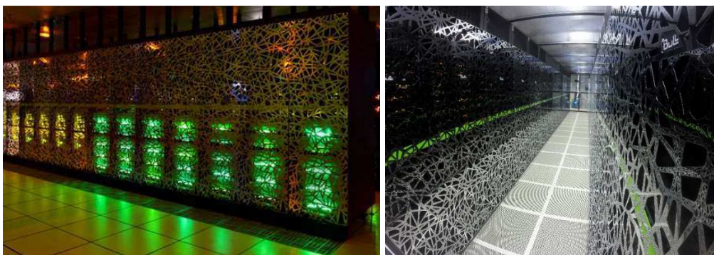
Fig. 2.22. Photographie de rangées de serveurs des 2 supercalculateurs utilisés dans le cadre de cette thèse : TGCC® du CEA (à gauche), et OCCIGEN® du Cines (à droite). En particulier au TGCC® c'est l'îlot AMD Irene ROME qui a été utilisée, et qui possède une puissance totale de calcul de 11.75 \text{ PFlops.s}^{-1} ( 11.75 \times 10^{15} \text{ Flops.s}^{-1} ). L'îlot Occigen® possède quant à lui une puissance théorique maximale de 3.5 \text{ Pflop.s}^{-1} . Crédits www.cea.fr et www.cines.fr .
