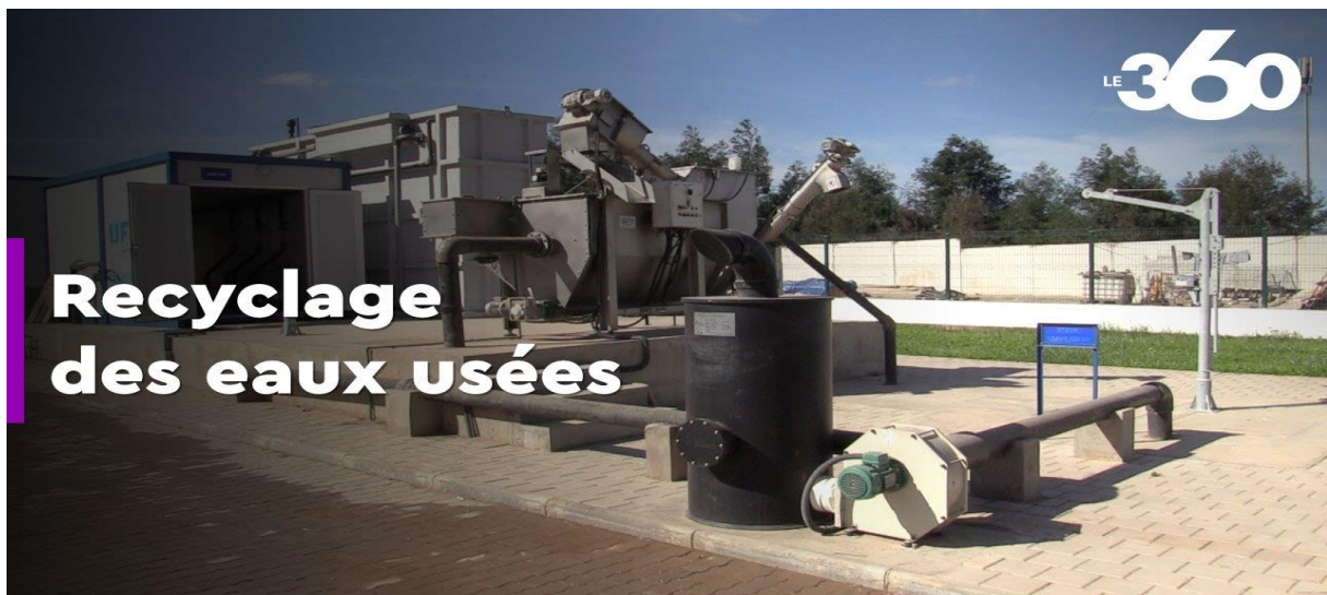
Figure 95. Une station d'épuration pour gestion hydrique durable à l'UIT
