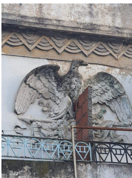
Figure 24 Façade détériorée à Bizerte. (Winou le Patrimoine, 2023)
