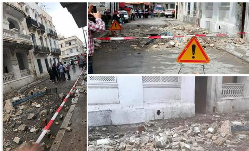
Figure 17. Effondrement d'un balcon et d'une partie de la façade d'un immeuble à la rue d'Atlas à Tunis (Source: Kapitalis, 2018)
