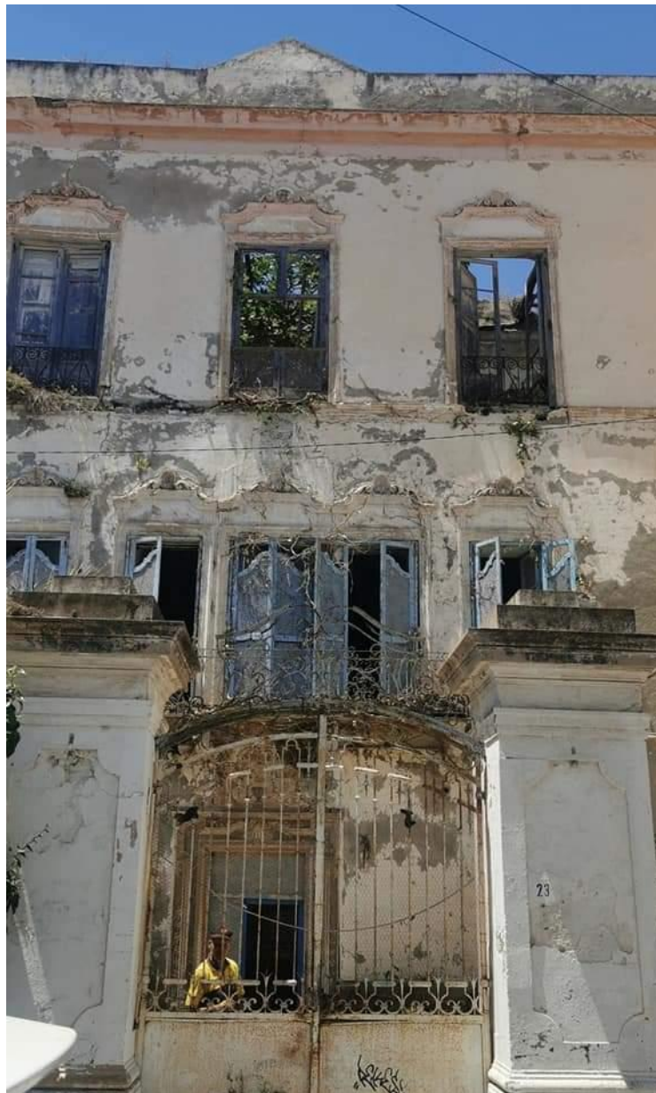
Figure 1. Interdiction d'accès au Palais d'Ahmed Bey de La Marsa (Source : Auteur, 2020)
