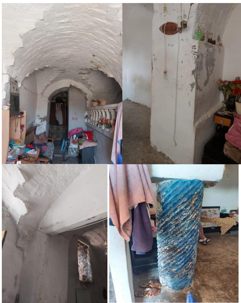
Figure 89. L'état insalubre et précaire de l'espace intérieur. (Source: Hamrouni, 2020)
